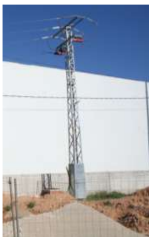
Imagen 7. Tendido eléctrico en el ámbito del sector.
